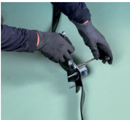
Wir legen die Kabel auf den Boden und markieren die richtige Distanz zwischen den Wagen. Danach legen wir das Kabel über das Fach des fixen Wagens RG3504, schrauben beide Elemente mit Hilfe der Schraube M6 des fachs des Wagens an.
